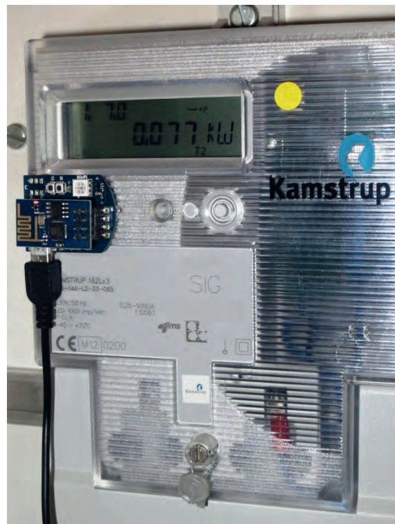
Figure 1 Compteur Kamstrup 162 des SIG avec l'appareil de lecture Kirfi.
