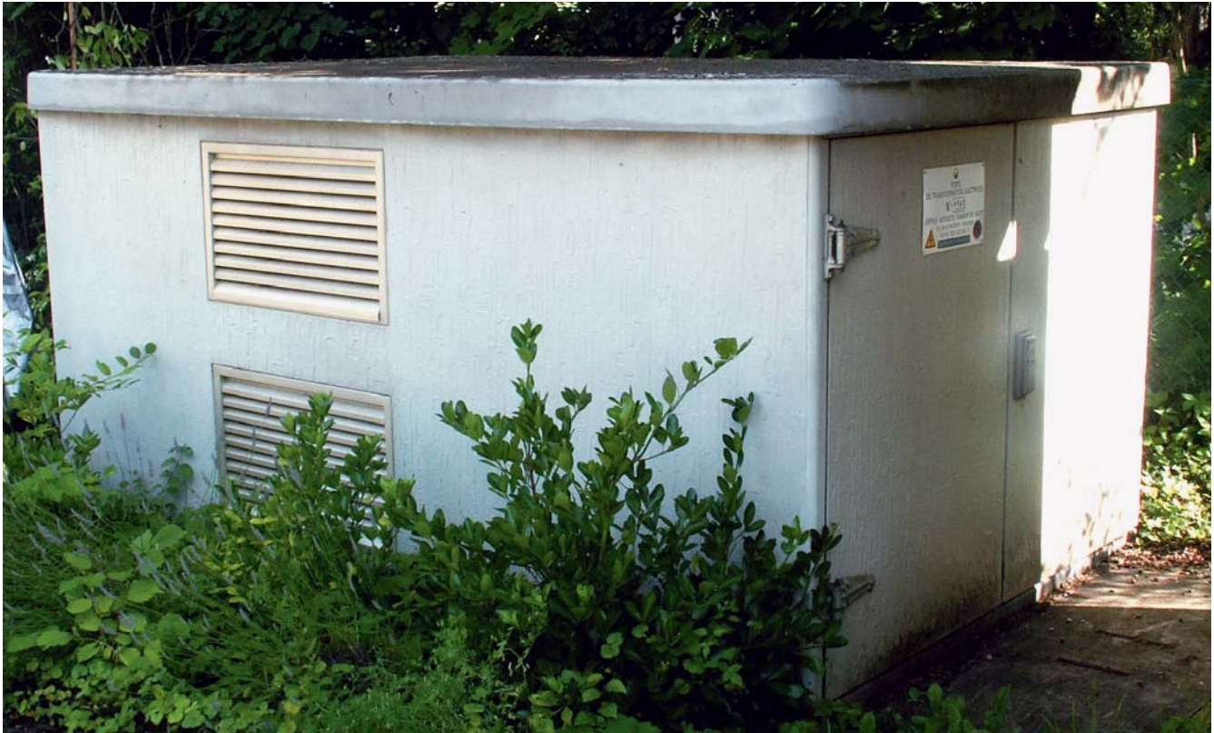
Poste de distribution MT/BT exploité par SIG en périphérie de Genève.
