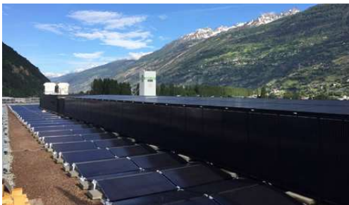
Figure 11 : Site 5 - EnAlpin PV
