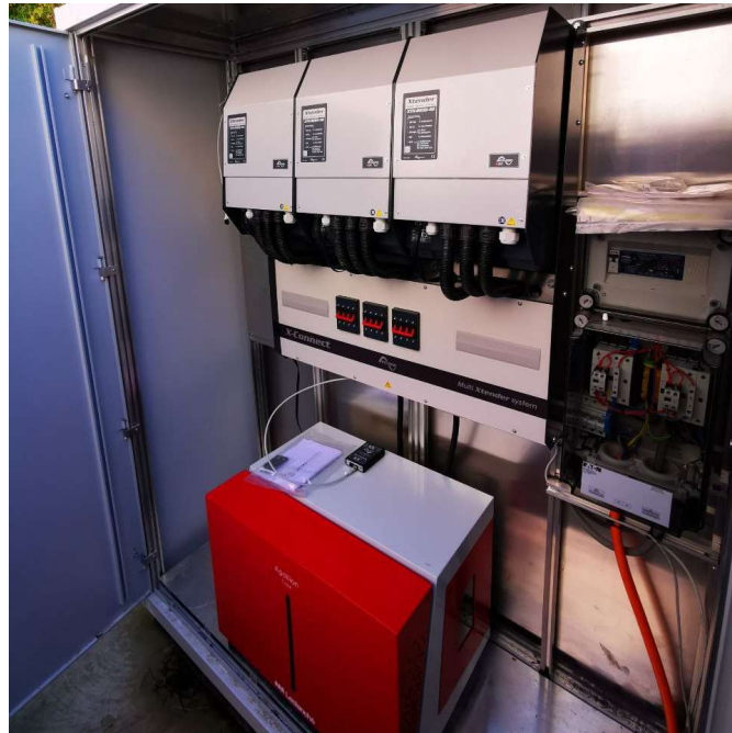
Figure 10 : Site 4 - OIKEN Boîtier contenant le solarlog et la box de pilotage qui permet la récupération les données
