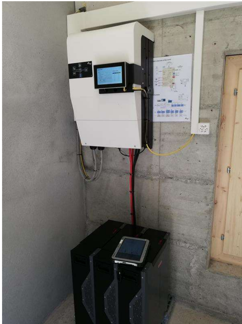
Figure 6 : Onduleur Next3 sur le site de FMA à Gryon
