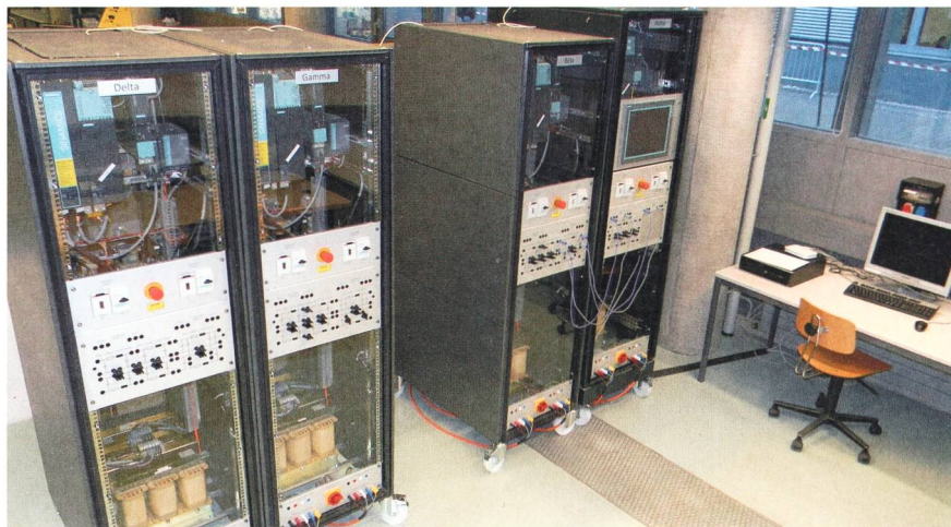
Figure 4 Maquette du réseau multiterminal DC au laboratoire : vue d'ensemble.
